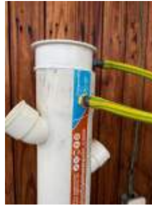
Figura 11. Sistema retorno de agua PVC Fuente: Autores
